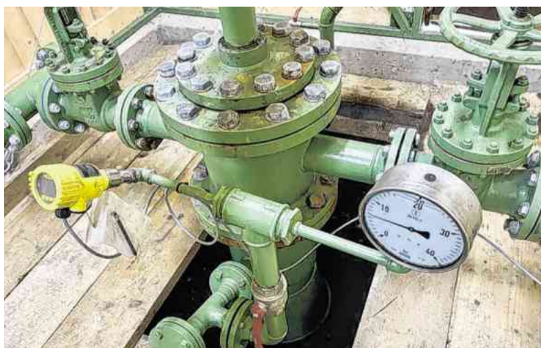
Durch dieses Rohr kommt Sole aus dem Erdreich.
